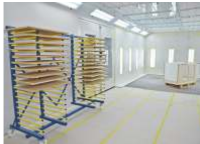
Die Pistolenaufhängung (links) ist mit einer Energiesparschaltung ausgerüstet. Lackier- und Trocknungsbereich gehen fließend ineinander über.
